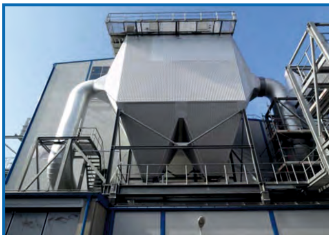
Instalacja filtrująca w Szwecji
